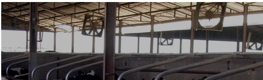
Figura 6 - Sistema de ventilação dos pavilhões.
